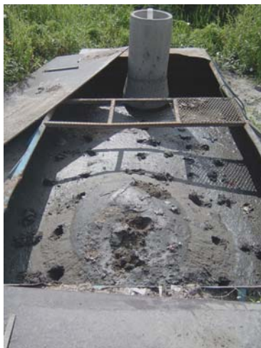
Figur 2: Container vid Rödbomotet. Provtagning av lakvatten skedde från ett grundvattenrör med slits som placerats inuti ett betongrör mellan betongröret och grundvattenröret har grus placerats som filter.
